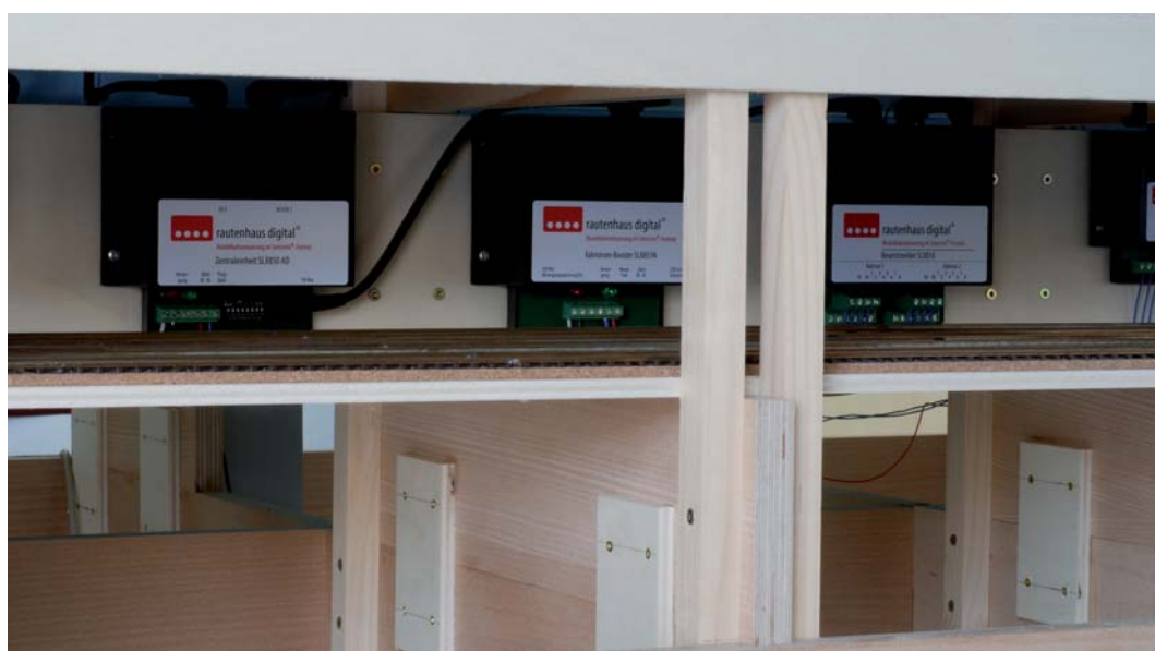
030 Ansicht der Blende hinter den Schattenbahnhofsgleisen. Alle Digitalbausteine sind vom vorderen rand der Anlage ohne Schwierigkeiten erreichbar.
